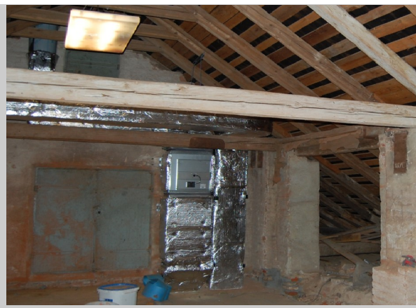
Strojovna výtahu – půdní prostor, VZT
